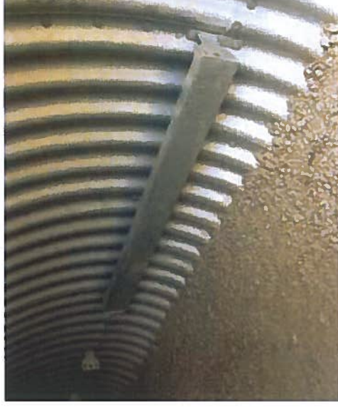
Foto - Exempel på montering av belysning i en rörbro, ljuset sprids uppåt.
