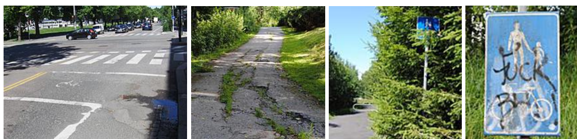
Figur 11: Exempel på dålig drift och underhåll. Från vänster: Utsliten målning, sprucken beläggning, cykelvägvisning skyddad av vegetation och nerklotttrad skylt. Källa: www.tiltakskatalog.no
