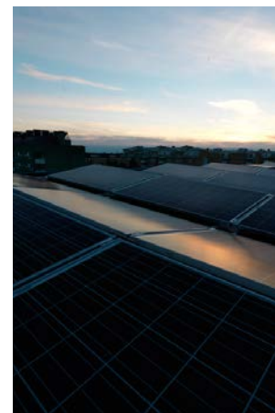
Solceller i Rinkeby: Järva är nu Sveriges solcellstätaste område med drygt 10 000 kvadratmeter solceller.
