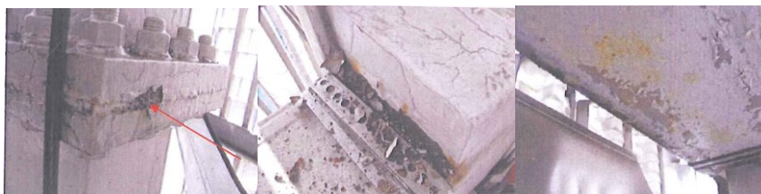
Del av korrosionsskador inventerade 2007
