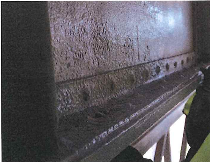
Bild 3: Tvärbalks underfläns med nästan bortrostade nitskallar.
