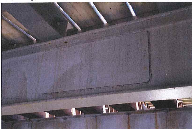
Bild 4: Långbalk med påsvetsad plåt
