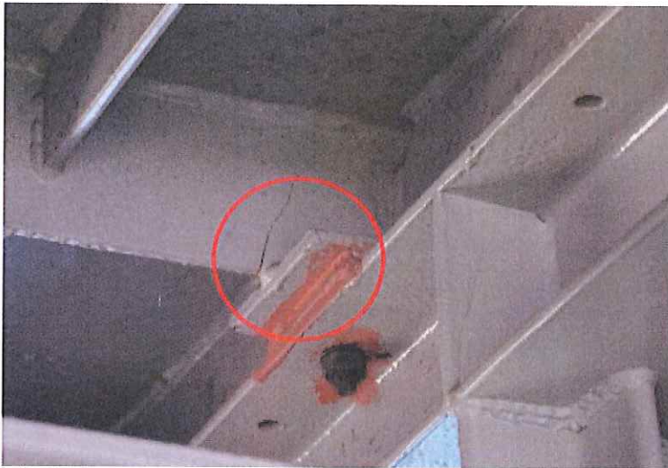
Bild 6: En av många spruckna knutpunkter på farbanans bärverk
