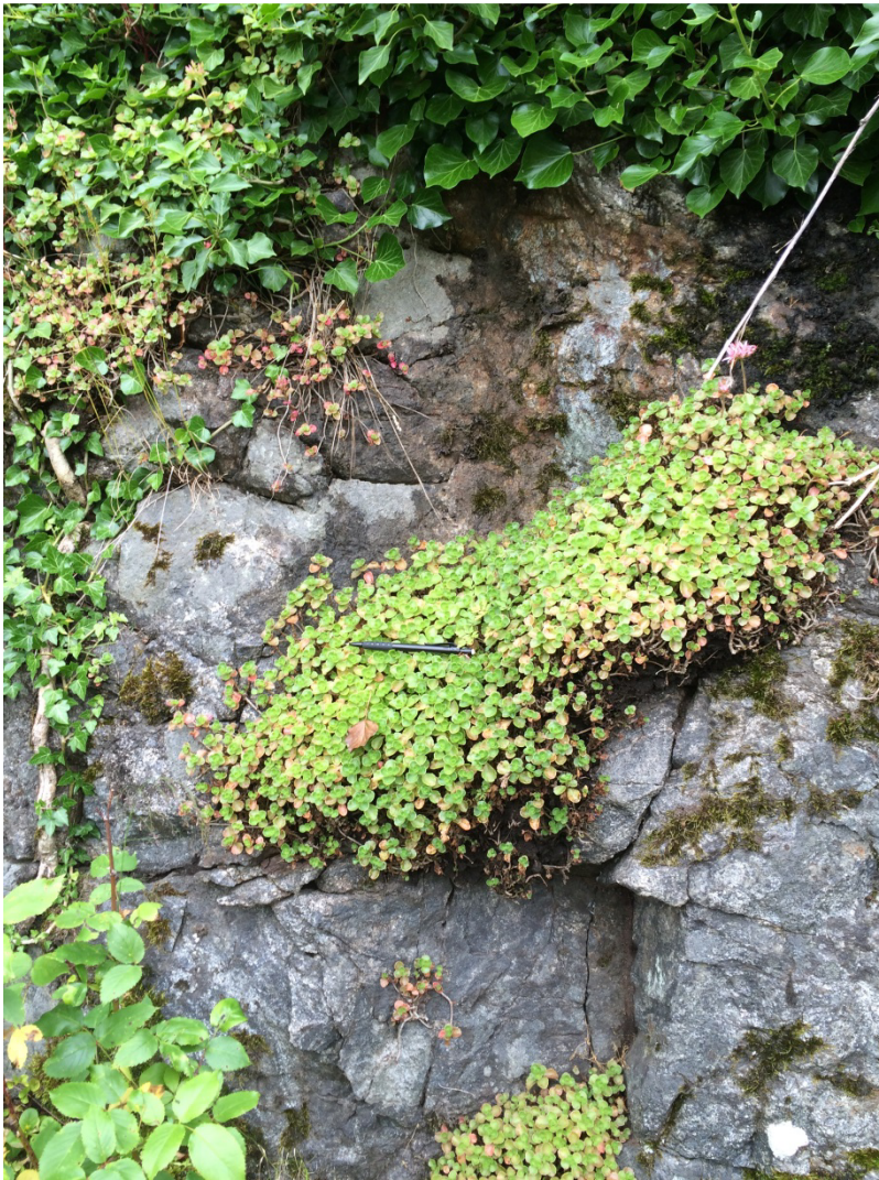
Figur 3. Naturligt utfall p.g.a. vittring och erosion.
