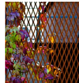
Räcken av brun perforerad plåt
