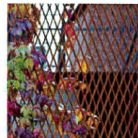
Räcken av brun perforerad plåt
