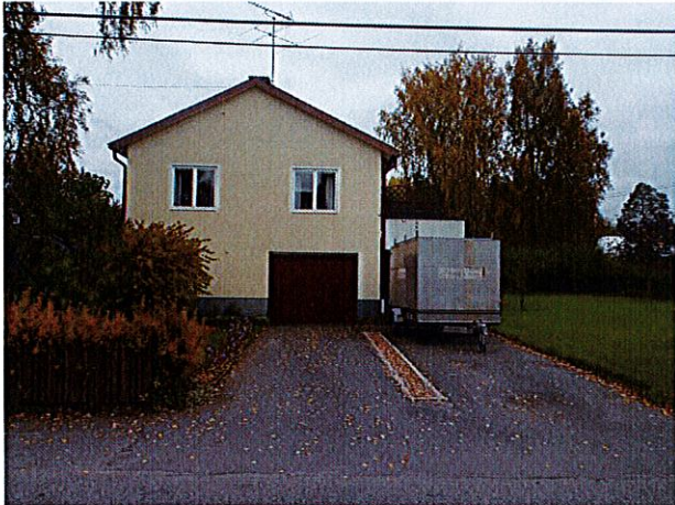
Bild 1. Hus vid Klockvägen. Stuprör går ned i marken. Fastigheten har enligt ledningskarta idag ingen anslutning till dagvattenanläggningen.
