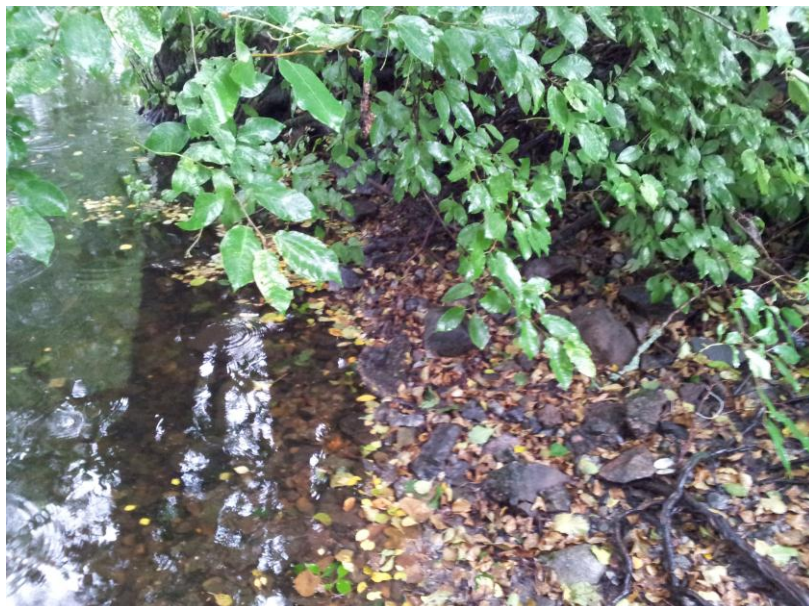
Bild 1 – Erosionsskydd vid Gudöåns strandbrink
