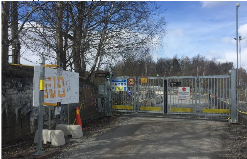
Bild 2 Automatiska grindar i Norra Djurgårdsstaden
