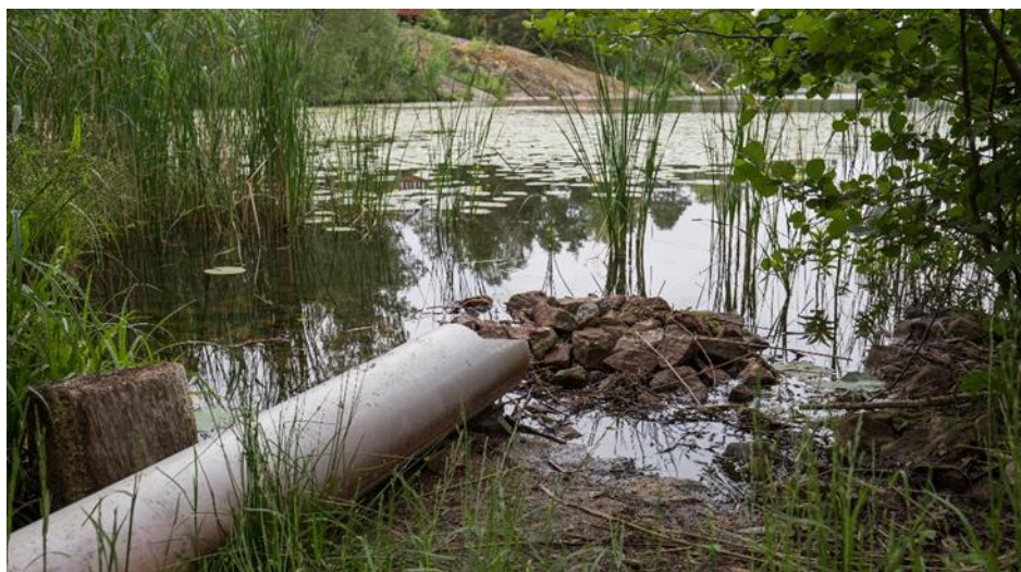
Figur 12. Utloppsledningen för dricksvattentillsättningen. Foto: Michael Wzdulski.
