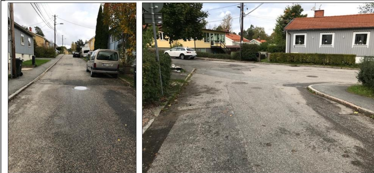
Figur 6. Bilderna visar Sandemarsvägen som avrinner mot Häringevägen. Sandemarsvägen har en kraftig lutning vilket ökar avrinningshastigheten vid regn och gatan saknar dagvattenbrunnar för att omhänderta dagvattnet. En ny dagvattenbrunn förslås, se även A i figur 4, vid korsningen på bilden till höger. En ny brunn gör att dagvattnet inte ska belasta nedströms liggande fastigheter.
