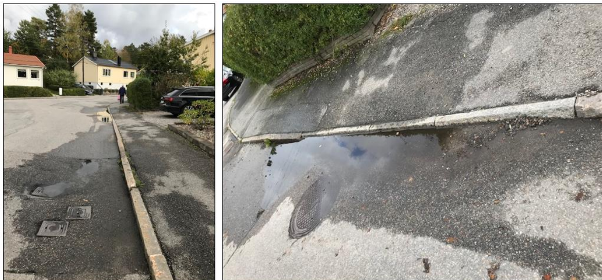
Figur 5. Bilderna visar den plats på Häringevägen där vattnet samlas och blir stående, se även figur 1. Vid större regn rinner vattnet över kantstenen och in på medborgares tomt. Befintlig dagvattenbrunn på platsen är felplacerad och behövs flyttas, se figur 4.
