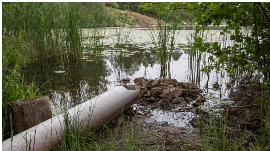
Figur 12. Utloppsledningen för dricksvattentillsättningen. Foto: Michael Wzdulski.
