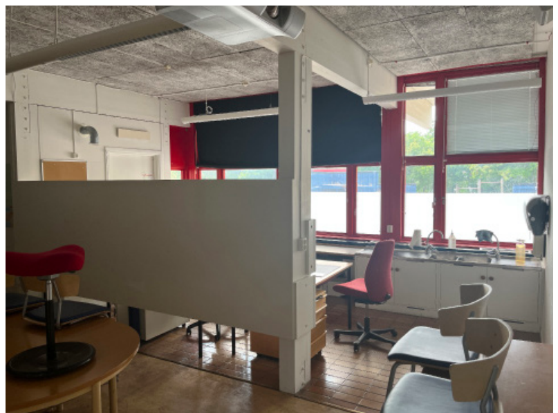
Ett av klassrummen har ej försetts med nytt undertak. Här är de ursprungliga träullslattorna synliga. Notera klinkergolvet som markerar kapprummets gräns mot klassrummet.
