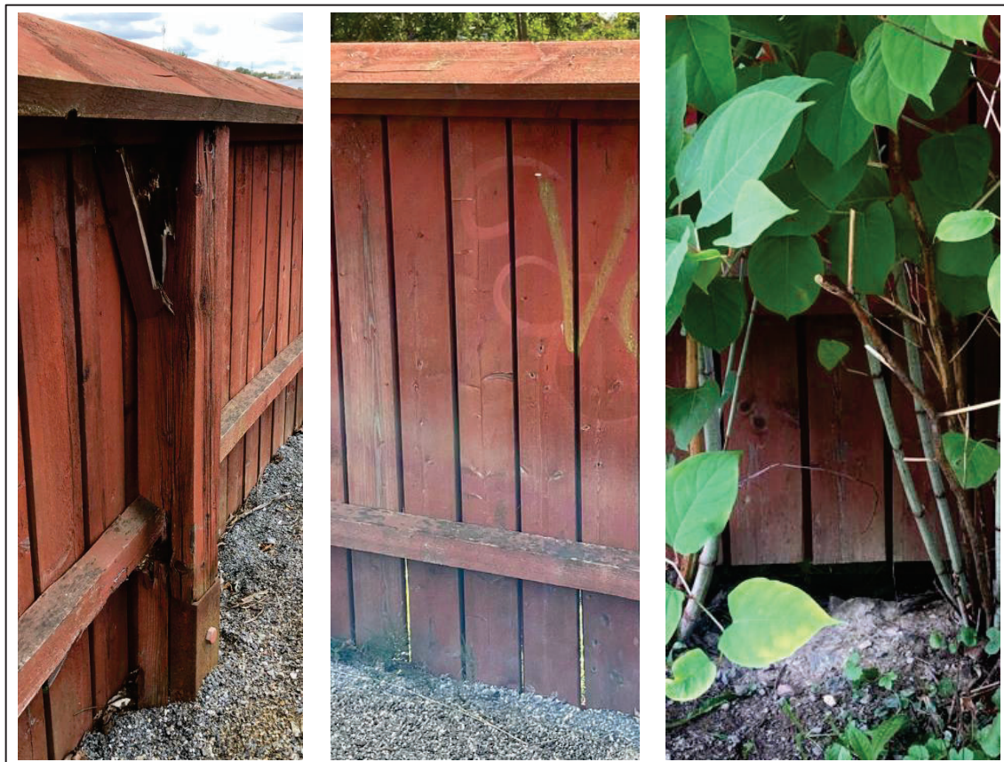
Figur 5. Exempel på otätheter hos befintlig bullerskyddskärm längs med Tyresövägen.
