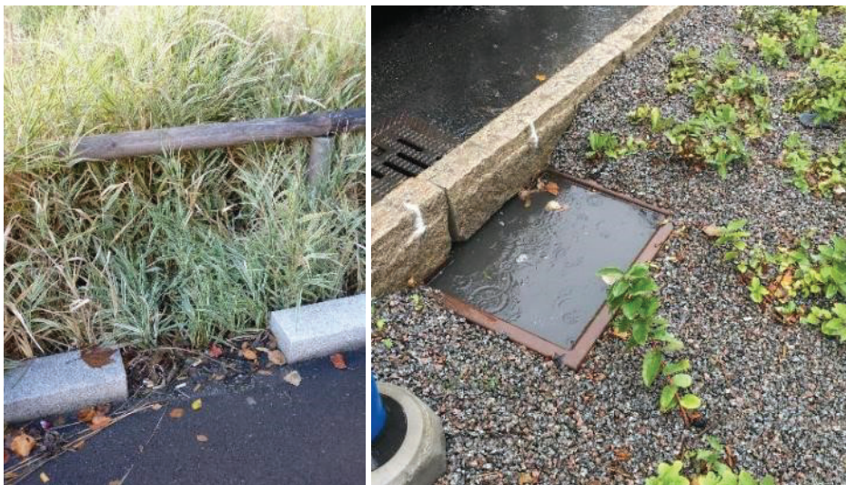
Figur 19. Intag från körbana genom öppning i kantsten (till vänster) och under kantstenen (till höger) med öppet sandfång. Foto: WRS
