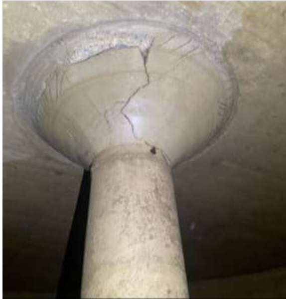
Bild 3: Betongpelare i krigsbranddamm före åtgärd
