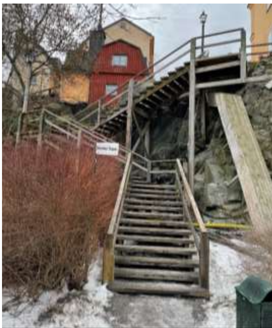
Bild 1: Dihlströms trappor före åtgärd
