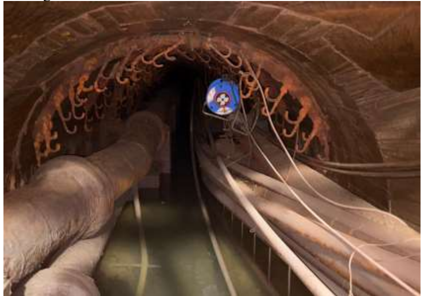
Bild 4: Foto som visar insidan av den teknikkulvert som innehåller installationer som försörjer broarna med bland annat el och fiber.
