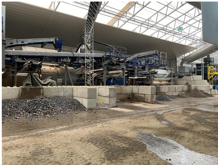
Bild 5 Torr- och våtsorteringsanläggning
