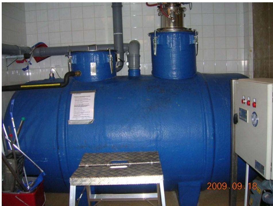
Tank till Envac MicroVac i Eriksdalsskolan
