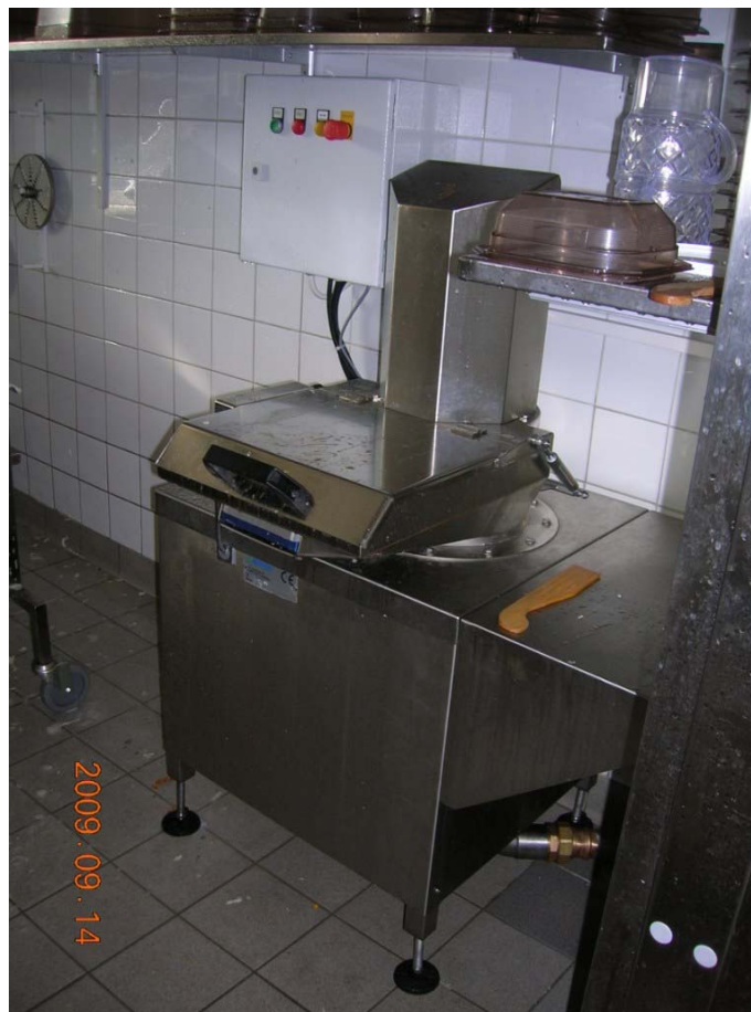
Kvarn Envac NanoVac med extern pump i Kärrtorps gymnasium
