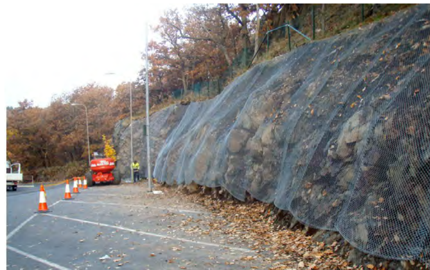
Referensbild bergsskärning med rasskydd. Denna åtgärd kommer främst att förekomma bakom bygnaden om det visar sig att det behövs.
