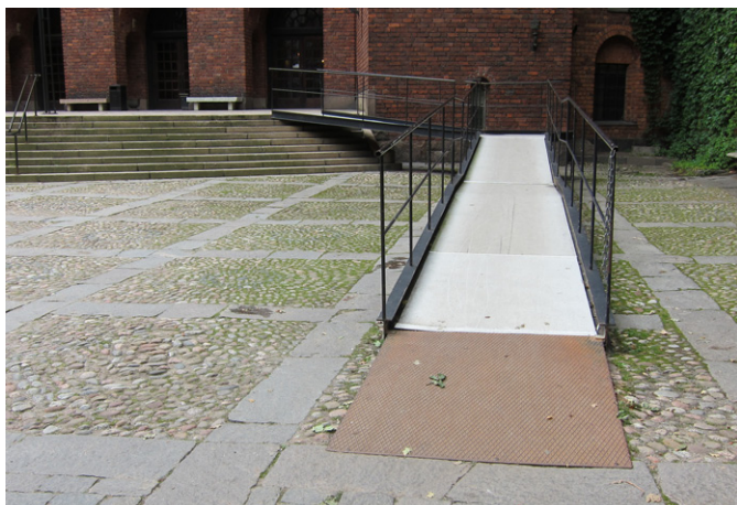
15. Rampen som leder upp till Blå Portens entré bör bytas ut.
