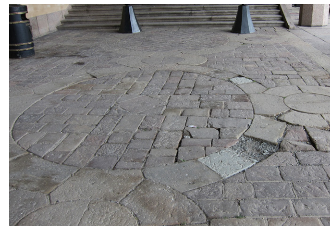
20. Flera kalkstenar har vittrat och behöver ersättas.
