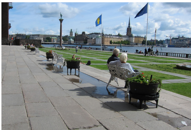
30. En sättning i markbeläggningen vid Mälärtrappan.
