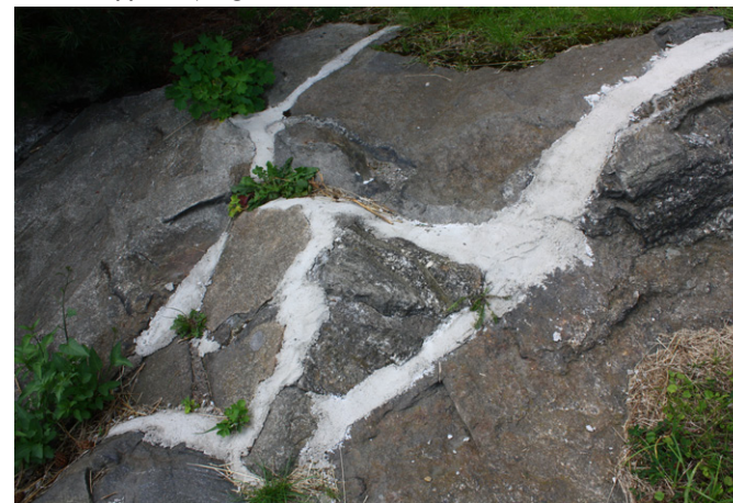
81. Fogarna mellan granithällarna är alltför synliga, Skärgårdsstranden.
