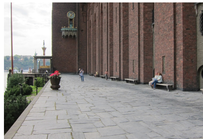
73. Markbeläggningen av svart skiffer har satt sig. Östra terrassen.
