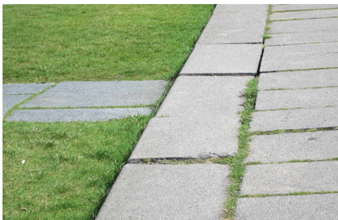
39 . Markbeläggningen på Sjöpromenaden har satt sig.
