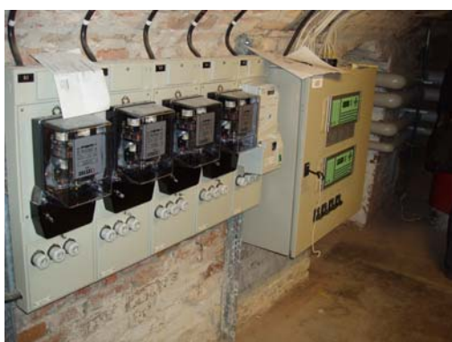
Mätare för hyresgäster hus 8 samt AS för styr av värmecentral
