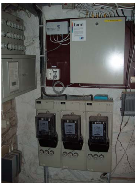
Centralutrustning för kabel-TV (hus 10)
