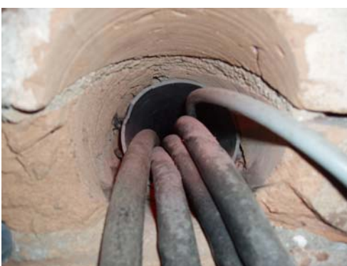
Kabelgenomföring mellan hus 10 & 12
