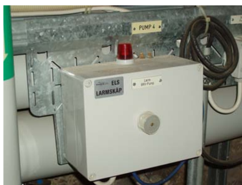
Larmskåp grundvattenpump hus 8
