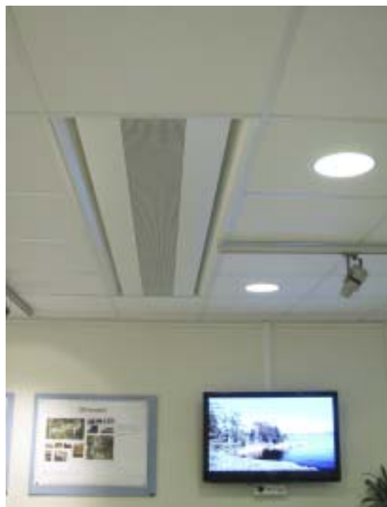
Ventilation i kommunens Servicecenter.
