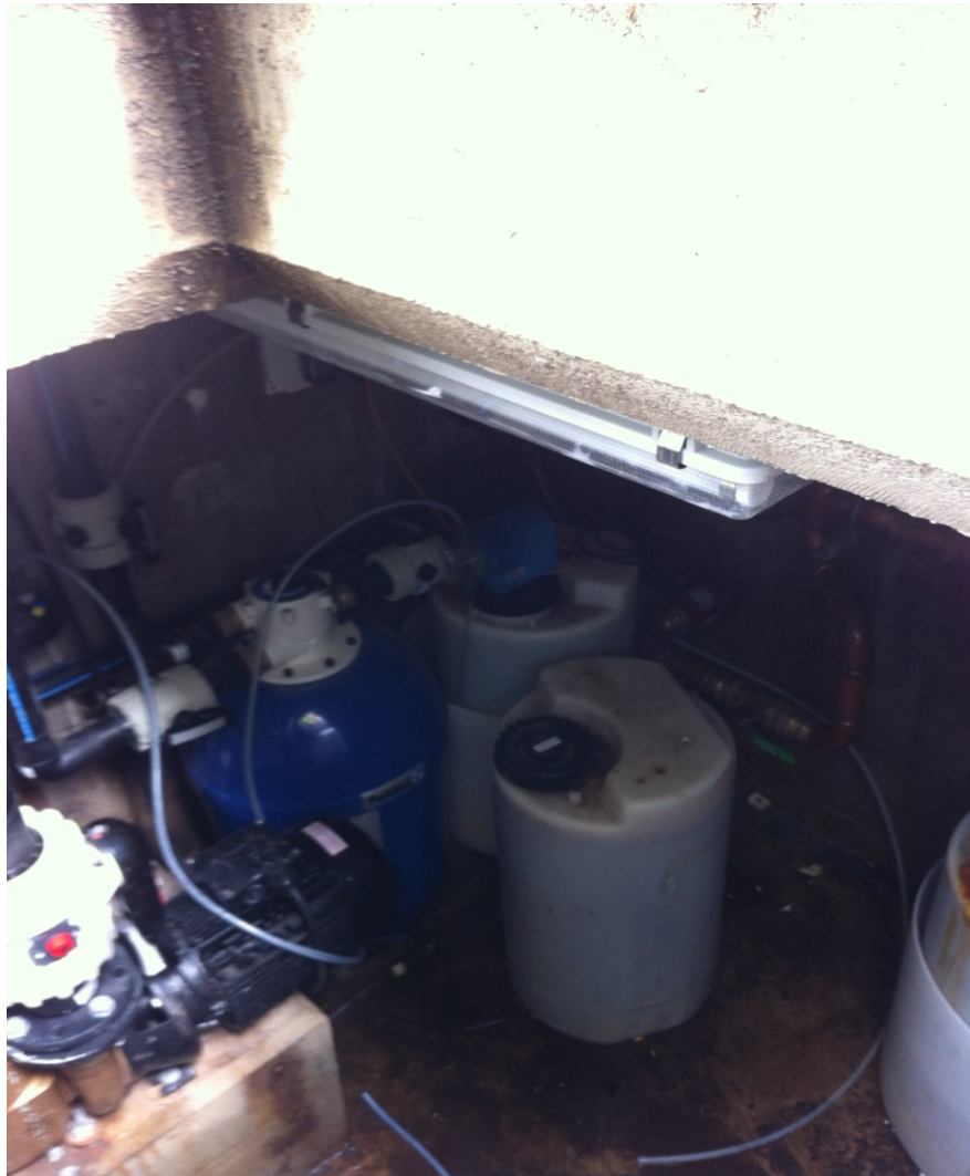
Litet sandfilter har installerats i den befintliga pumpgruppen
