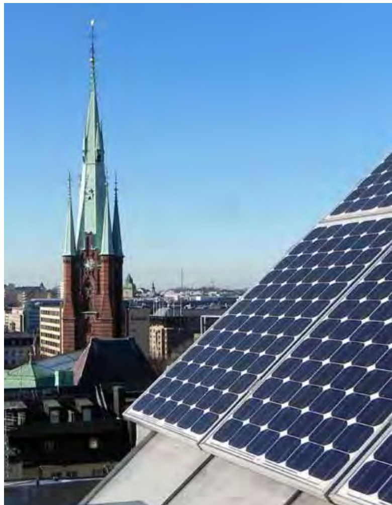
Solcellsanläggning på Kulturhusets tak. Foto: Lovisa Lagerblad/Länsstyrelsen.
