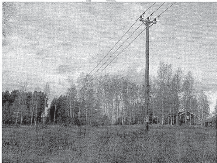
Figur 7 Luftledning med isolerade (plastbelagda ledare), 10 kV
