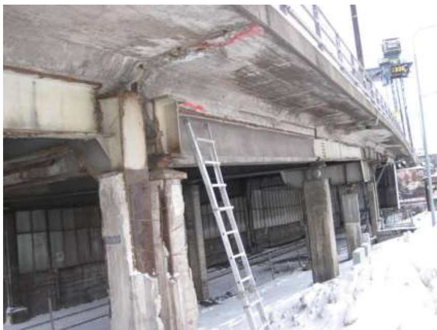
Skador vid Saltsjörampen
