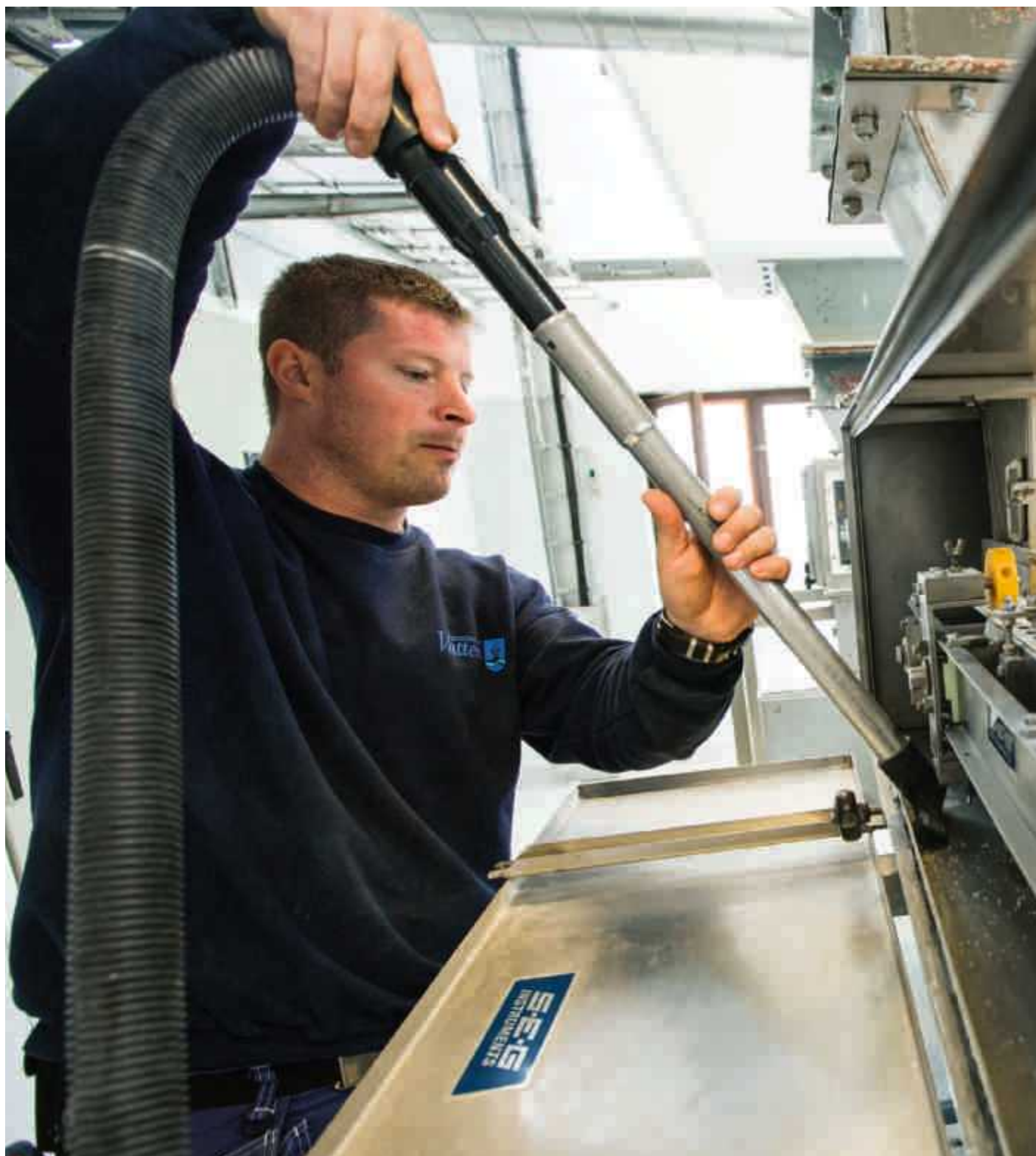
DE OLIKA STEGEN I RENINGSPROCESSEN ÖVERVAKAS OCH UNDERHÅLLS NOGA.
