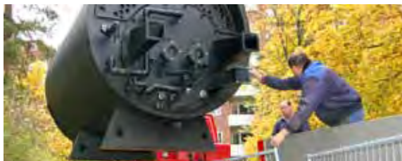
I Västertorp monterades en ny pelletspanna som en del i satsningen på uppvärmning med förnyelsebar energi.
