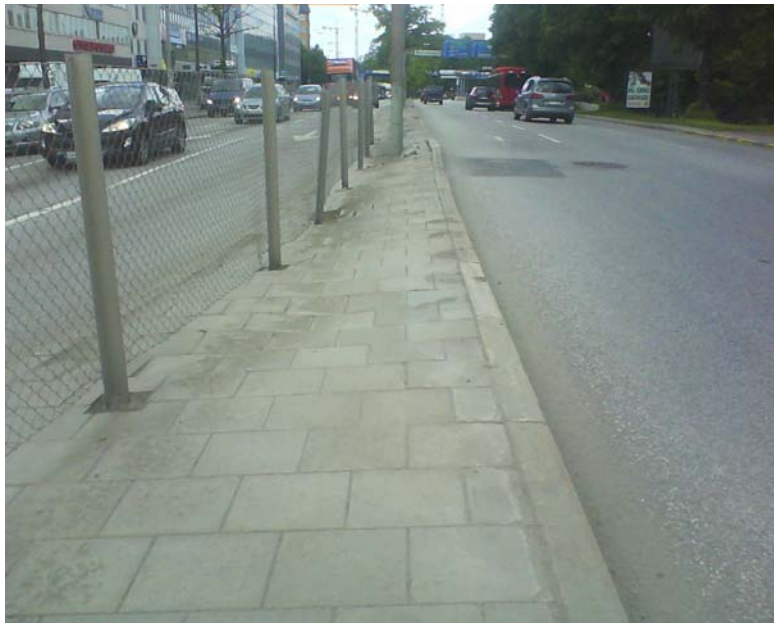
Figur 3. Sättningskador vid Roslagstull/Norrtull juni 2012.
