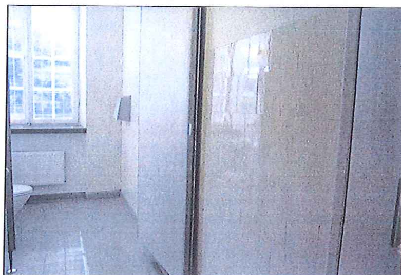
Badrummets kakel har bevarats på tre väggar. Badkaret är rivet. Yttre delen av rummet används som tvättrum. Rum 026, 027.
