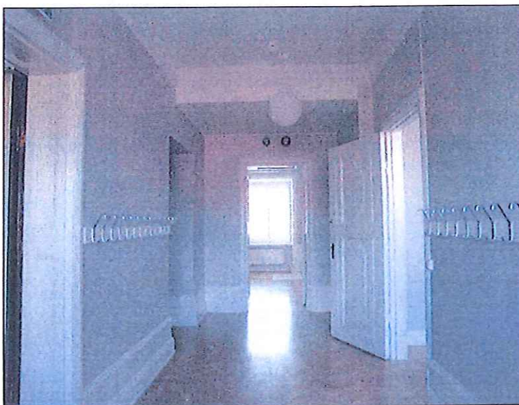
Samma vy efter renoveringen. Ventilationsdragningar och täta undertak har undvikits i rum med stucktak i hela byggnaden. I just detta läge har dock en dragning skett, på samtliga plan, längst in i rummet. Den har klätts in i en tät "låda". Rum 322.
