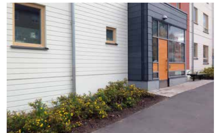
Sköndal. Målad betongsockel, med täta rillor och utan rillor, med plantering framför.
