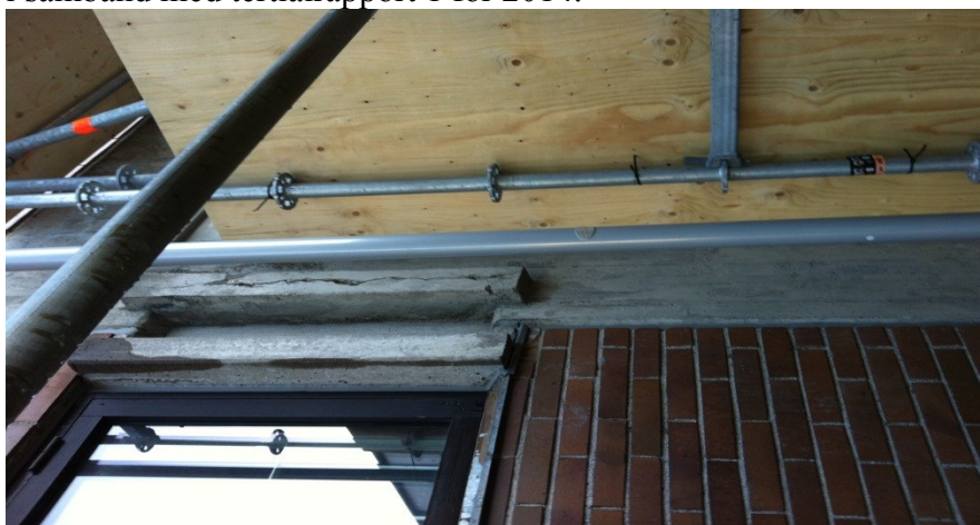
Bilden visar exempel på skador som finns ovanför fönstren
