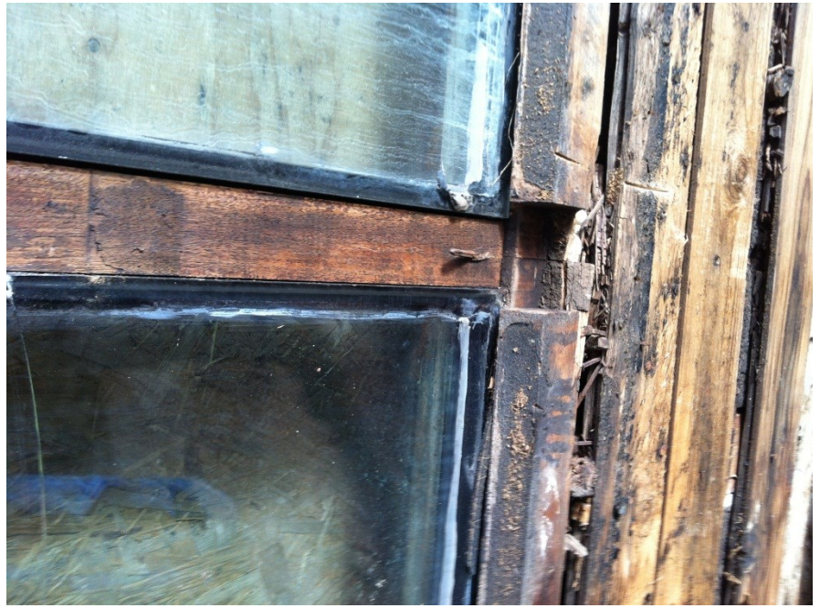
Exempel på skadade träakarmar runt ett fönster
