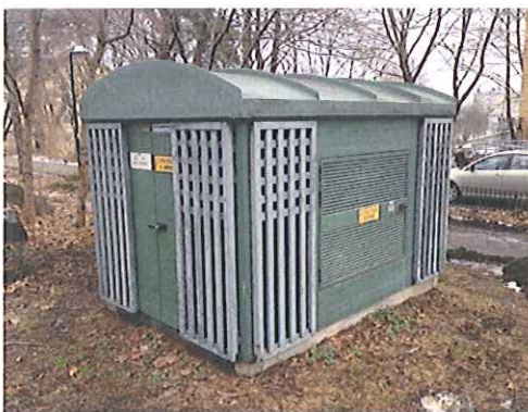
Befintlig elnätstation som ska flyttas
