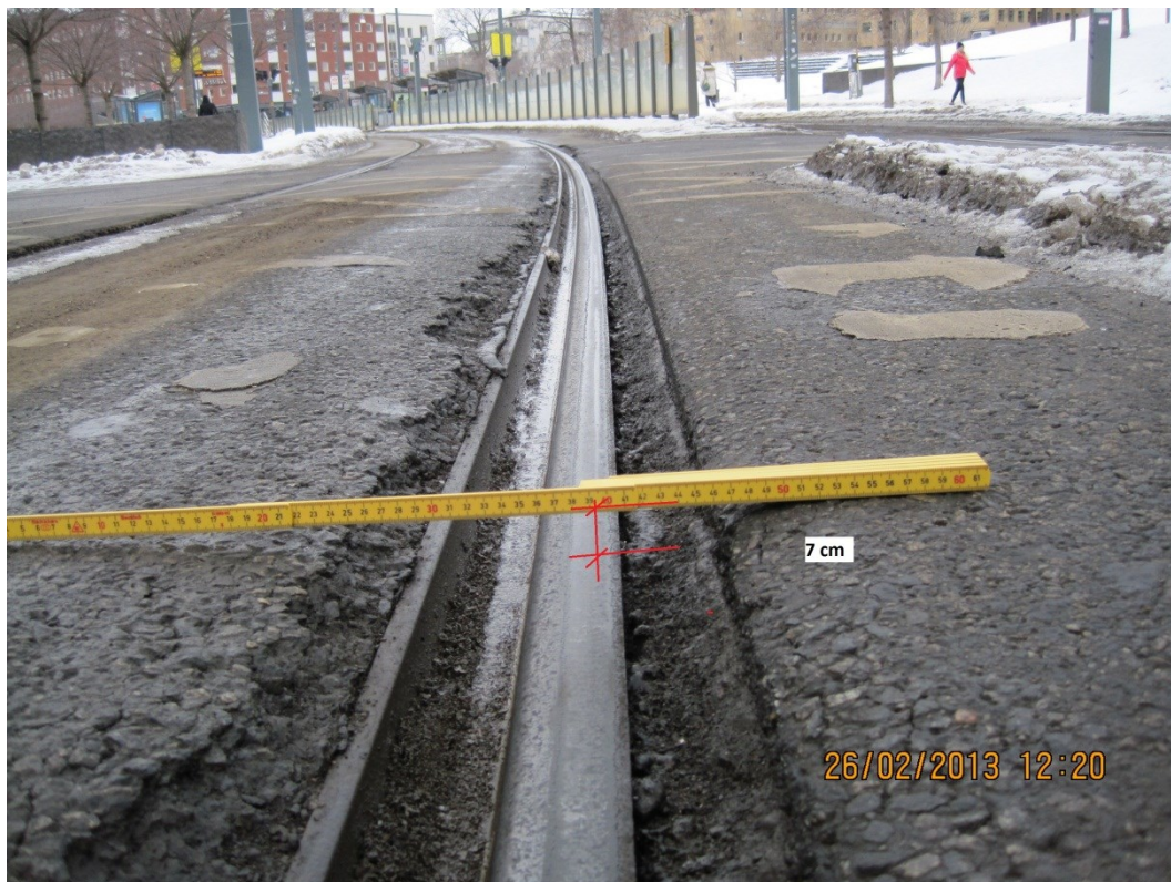
Spår som sjunkit på flera ställen samt skadad beläggning i anslutning till spår.
