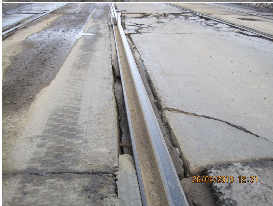
Omfattande skador i anslutning till spåren längs sträckan Sickla Udde och Alvik.
