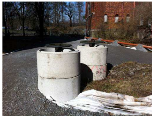
Bild gasregulatorer (med tillfälliga skydd) mellan gasklocka 1, 2 och hus 7.
