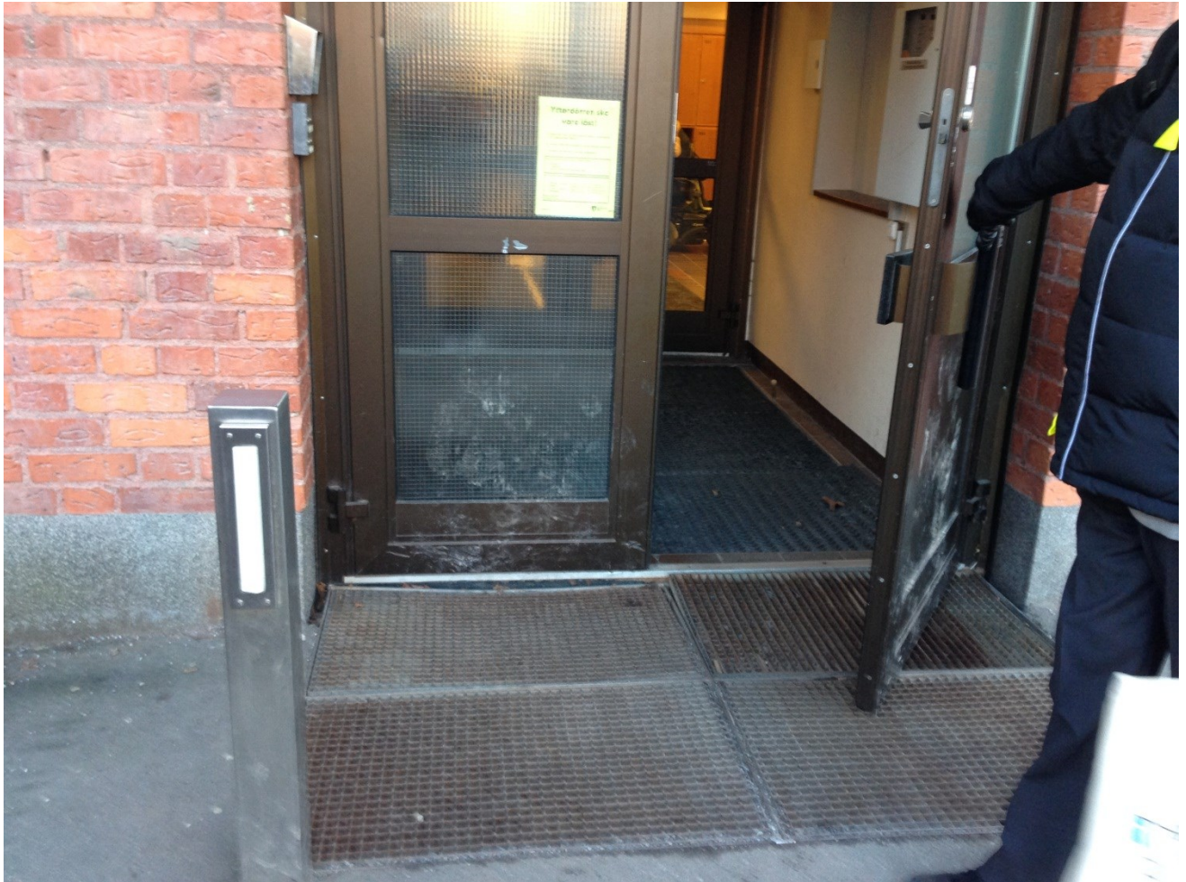
Dörröppnare som 2015-03-05 vid besöket inte fungerande. Finns enbart på den yttre dörren.
