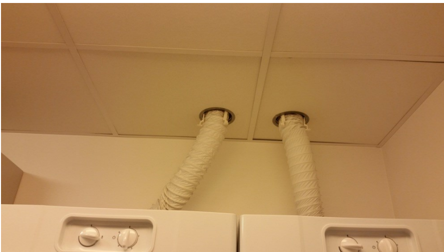
Figur 3. Felkopplade slanger till torkskåp. Det bör vara ett avstånd mellan slang och tak så att även rumsluften kan gå ut via ventilationen.
