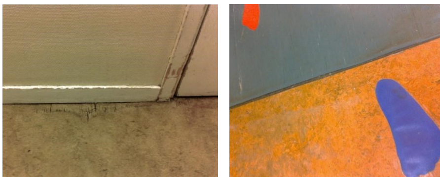
Figur 4. Trasiga golvbeläggningar. En sprucken, spröd golvmatta efter vattenskada och en klabbig golvmatta med sprucken skarv.
