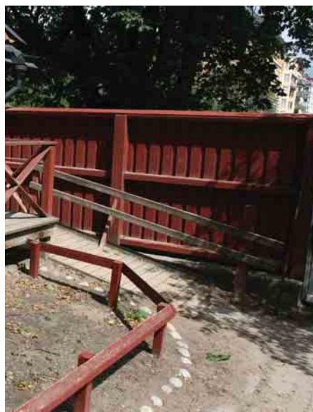
Brant ramp till handikapptoaletten.
