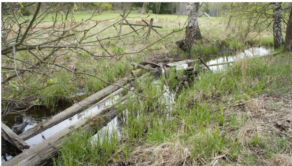
Bild 10. Plankor mm som hindrar vattenflödet i bäcken bör rensas bort.
