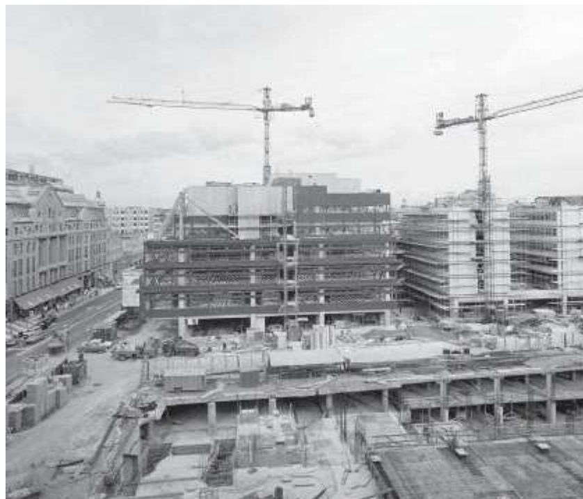
Foto från ca 1974-75. Närmast i bild syns pågående byggnation av kvarteret Trollhättans två nedersta våningsplan under mark som bland annat innehåller garage och spärrhall till tunnelbanan. Kvarteret Spektern är under uppförande på andra sidan Regeringsgatan. Till vänster syns Nordiska Kompaniets byggnad vid Hamngatan. Fotografen är Lennart af Petersens. Källa: Stockholms stadsmuseum.
