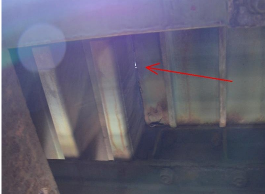
Kassetter, rost och spricka vid pilspetsen
