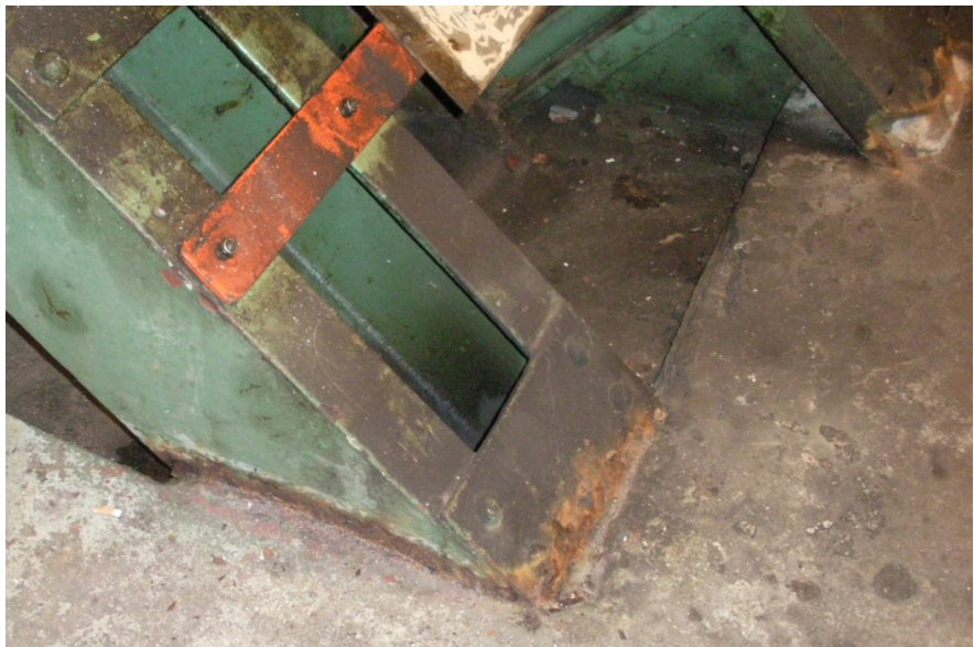
Typisk rostskada där ingjutningsgodset möter betong
