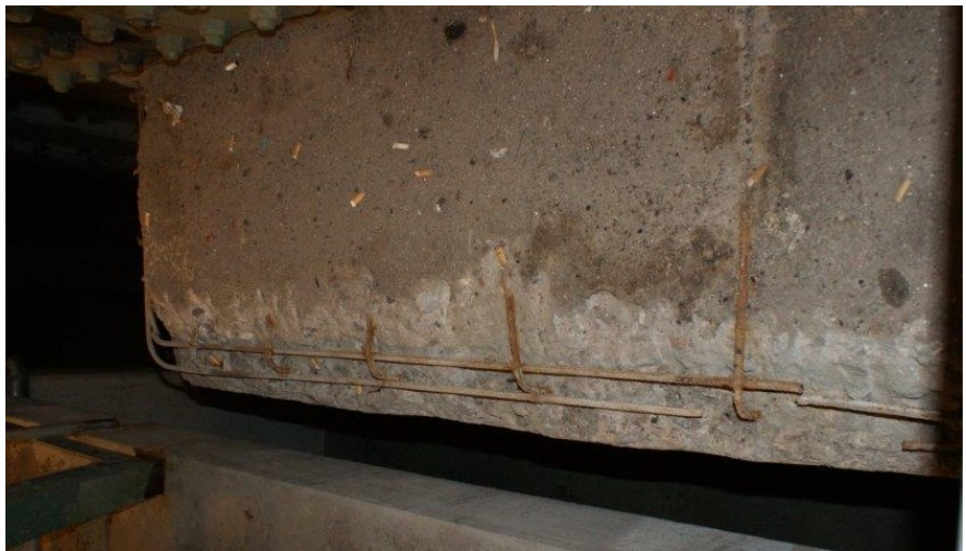
Rostande armering som spjälkat bort omgivande betong
