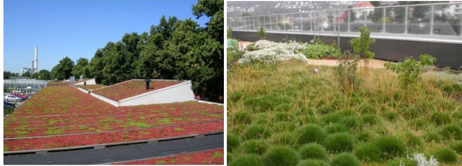
Figur 13. Gröna tak med olika karaktär och fördröjningsförmåga
