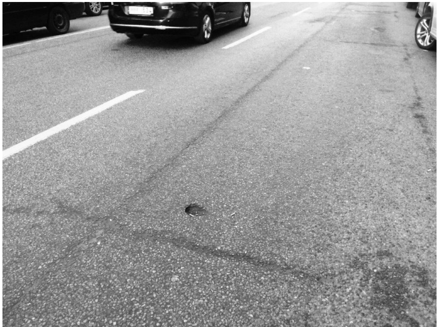
Längsgående sprickor, stensläpp och begynnande potthål
