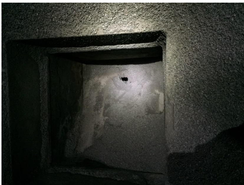
Ett igensatt utlastningshål
