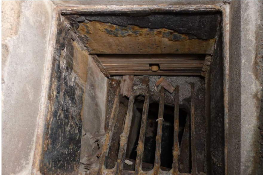
Ett sönderrostat utlastningshål
