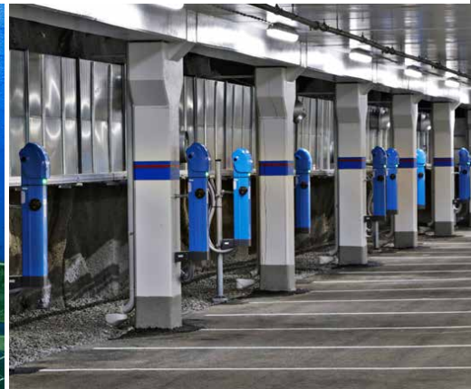
▲ I Stigbergsgaraget har Stockholm Parkering installerat åtskilliga laddplatser för elbilar.
