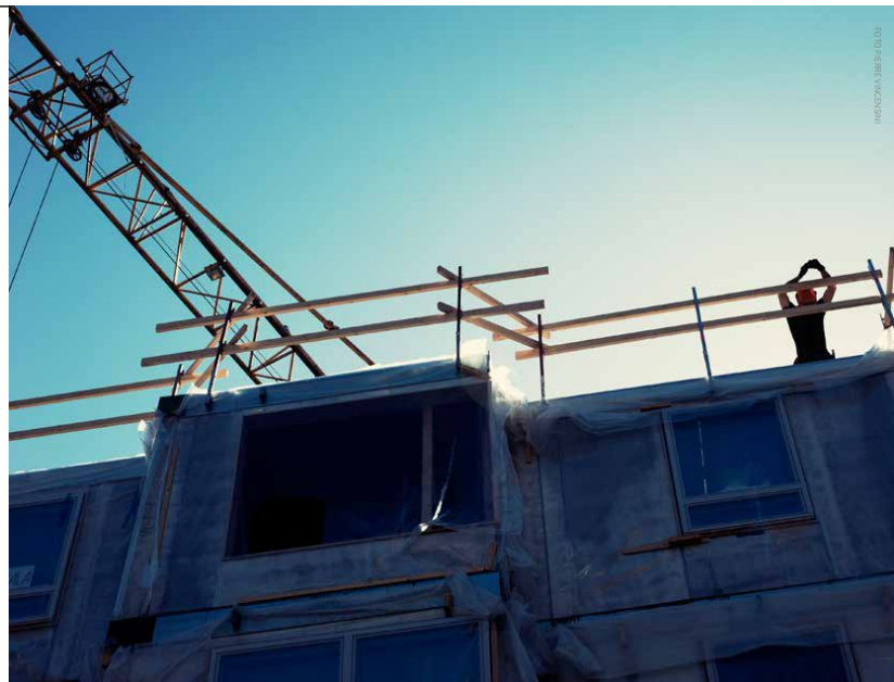
▲ Med satsningen Stockholmshusen samlar Stockholms stad sin bostadsbyggarkraft med målet att i hög takt bygga kostnadseffektiva hyresrätter.
