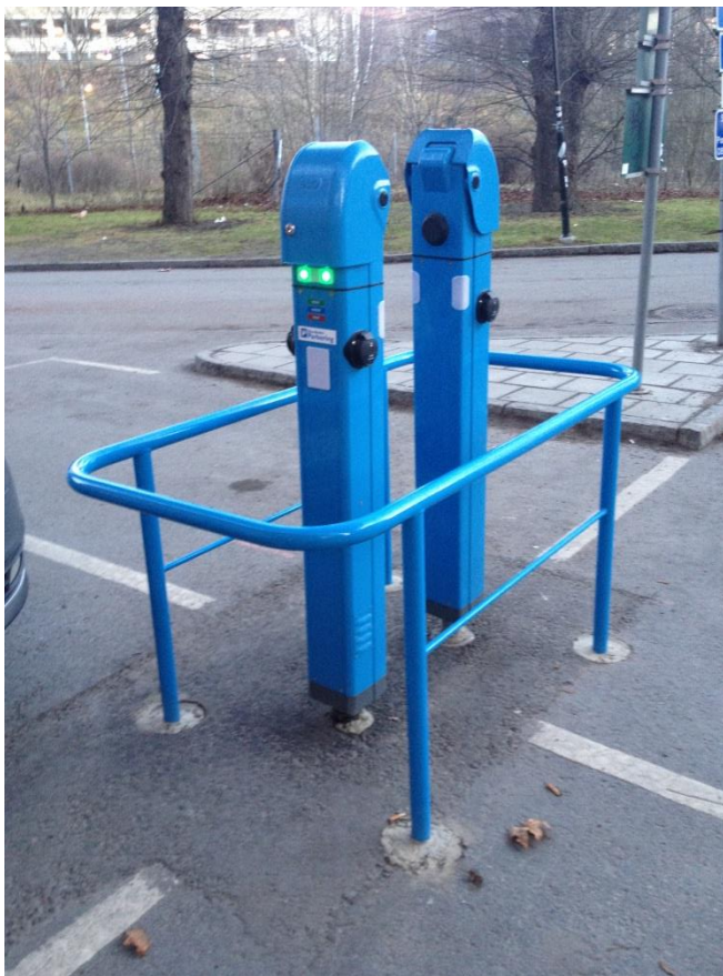
Det kan vara bra att sätta upp påkörningsskydd framför laddstolpar på utsatta platser. Bilden kommer från Stockholm Parkerings anläggning vid Eriksdalsbadet.
