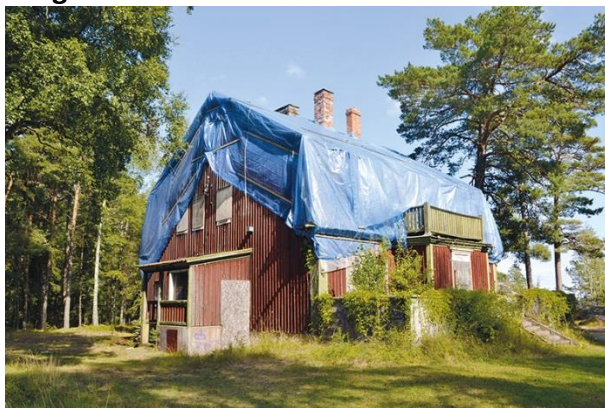
Figur 22 Susegårda, Byggnaden har stått utan underhåll under lång tid
